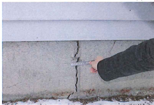
(d) wide crack opening
