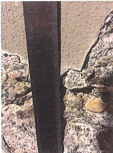
(d) wide crack opening
