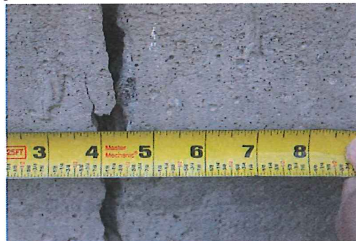
(d) wide crack opening
